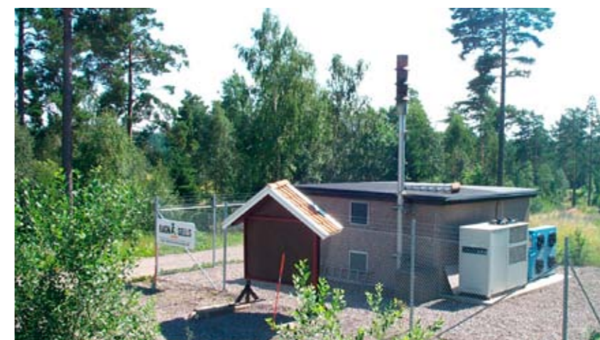
Gasåtervinningsstation vid Högbytorpsanläggningen.
